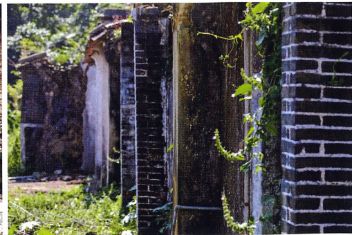
村民移民後，部分舊屋日久失修和只剩幾堵牆壁。
